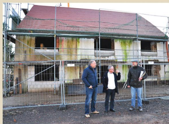
Bauamtsleiter Stephan Barth, Bürgermeister Armin Emanuel und Architekt Roger Caspar im Frühjahr 2014 vor dem alten Zollhaus. Das Dach wurde bereits neu eingedeckt, der Innenausbau ist im Gange.
