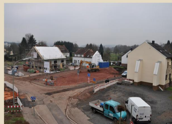
Zwei Häuser im Umfeld des alten Zollhauses waren zunächst stehen geblieben, konnten aber dann von der Gemeinde erworben werden. Das Anwesen Hüttenstraße 1 wurde auf diesem Foto bereits abgerissen.
